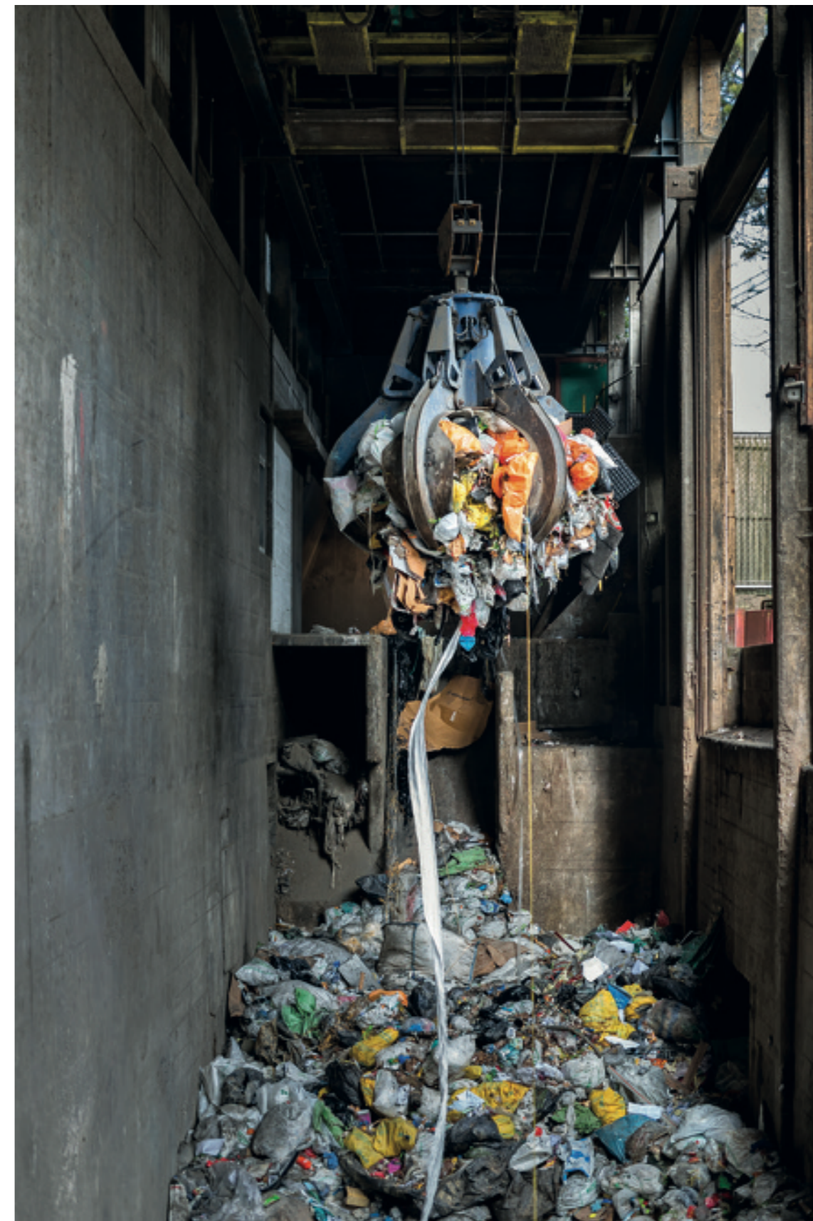
La fosse de Valorsa peut recevoir jusqu'à 700 m 3 de déchets incinérables et est liée au centre de compactage
